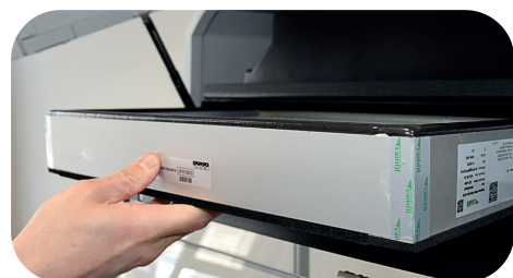
Abb. 49: Entfernen des HEPA-Filters
